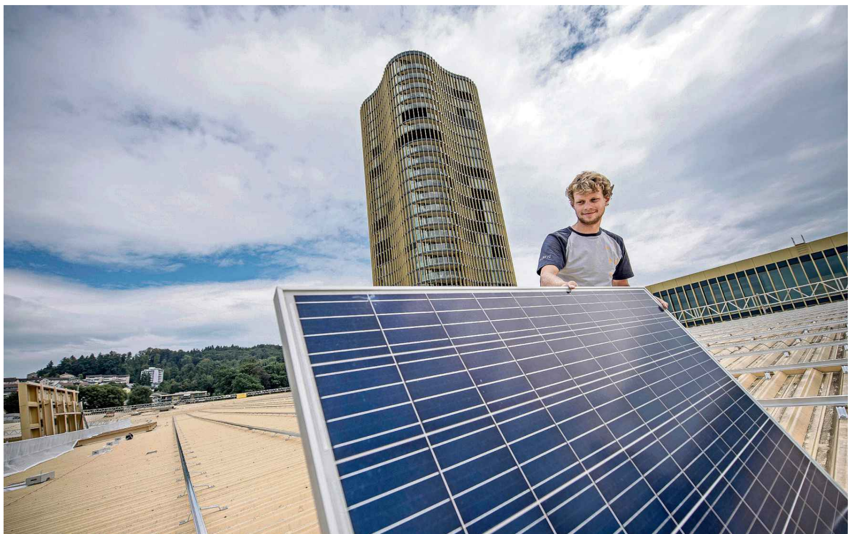
Das erste Solarpanel ist schon da. Solarmonteur David Müller platziert es an der richtigen Stelle. Bild Pius Amrein
