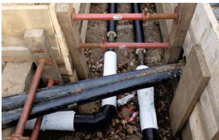
Die Investitions- und Unterhaltskosten für Fernwärmeleitungen sind hoch.
